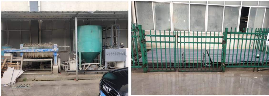
压滤机及三级沉淀池
