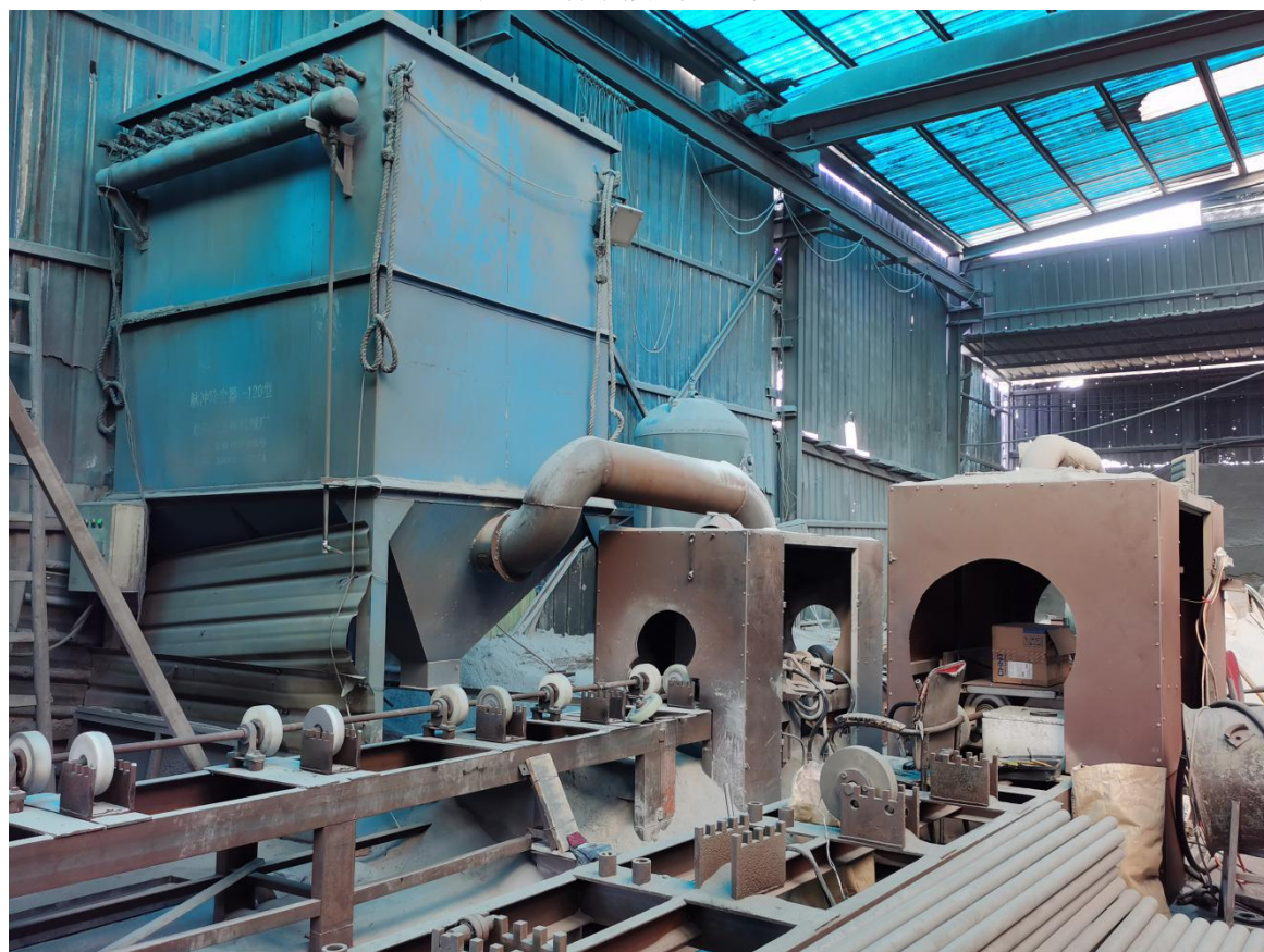
图 3-4 喷砂废气处理设施
