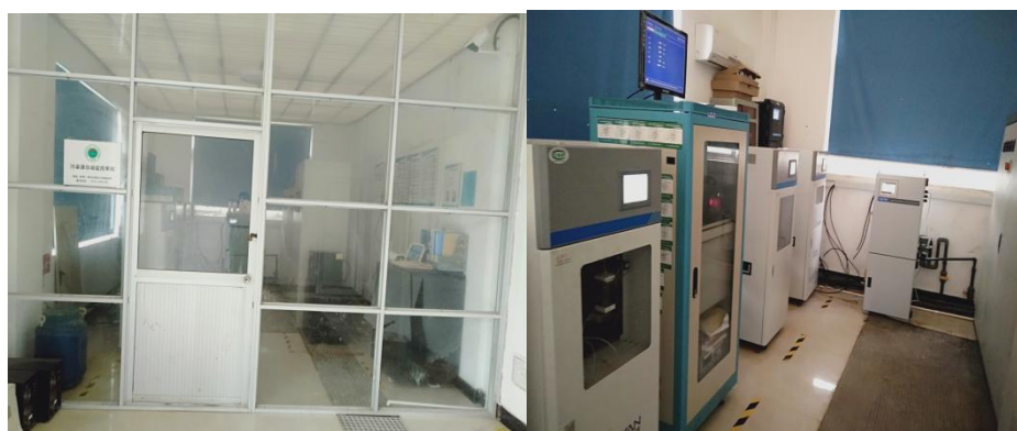
图 4-4 废水在线监控设施
