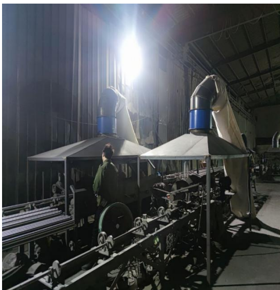
废气收集装置
