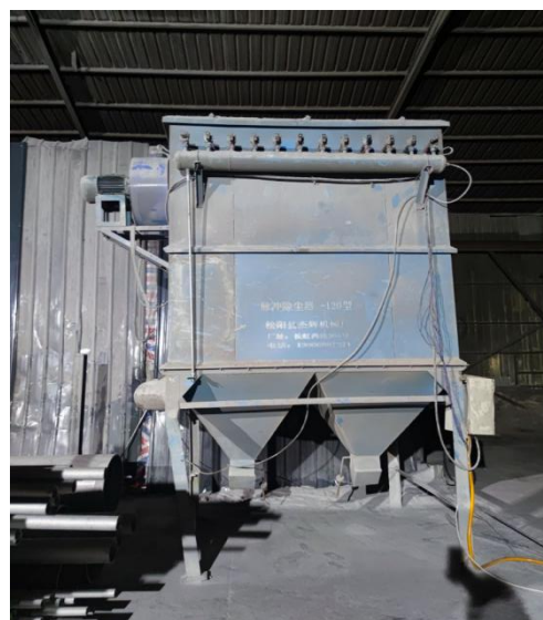
布袋除尘废气处理设施
