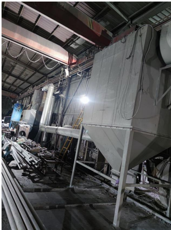
布袋除尘废气处理设施
